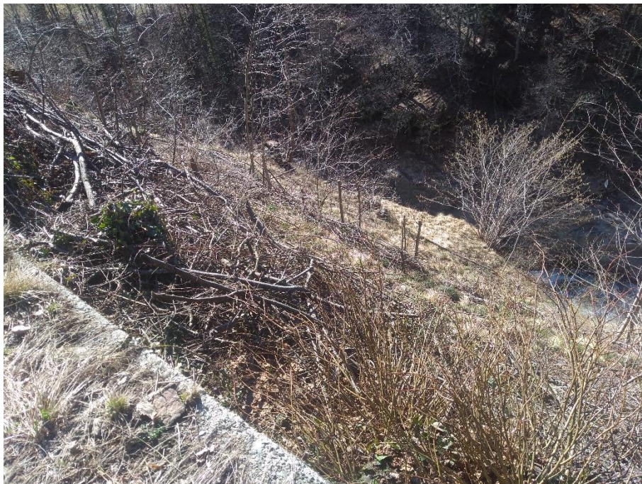
Figura 8 - Rientranza con spuntone roccioso da verificare (in alto vista dalla SP10 e in basso dalla strada sterrata)
