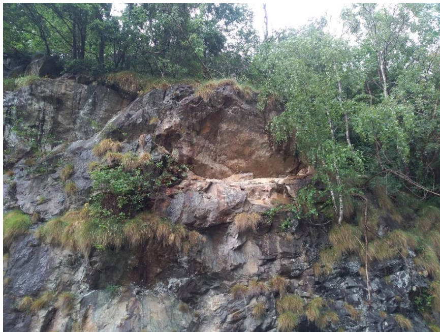
Figura 6 – Parete rocciosa presso il sito di intervento recentemente interessata da distacco
