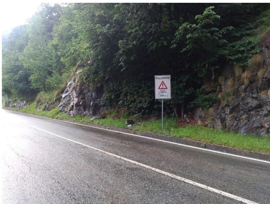
Figura 7 - Blocchi di roccia staccatisi dalla parete presenti a bordo strada
